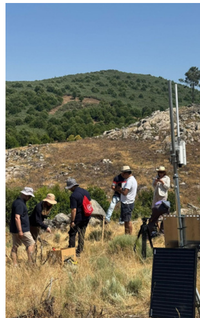
Instalación de sensores dentro del despliegue previsto en 2025 para la detección temprana de incendios forestales.
