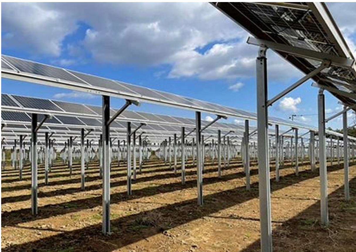
Imagen 2: Estructura fija elevada
