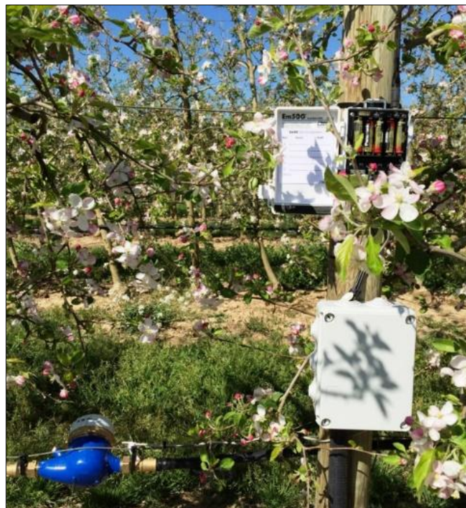
Figura 6: Vista frontal de un datalogger Em500 alimentado por pilas con un contador de agua por pulsos en un campo de manzanos.
